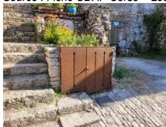
Exemples – compteur électrique
